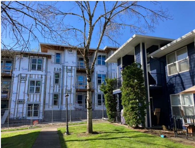
포틀랜드에 건립 중인 주택. 기존 2층 주택단지(오른쪽) 옆에 3층 아파트(왼쪽)가 건립되고 있다./강동호
